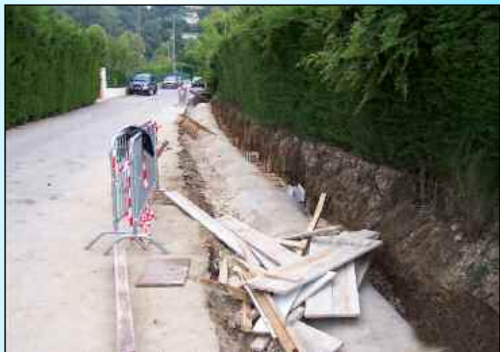
Réfection du Vallon des Mîtres, boulevard des Avelaniers, détérioré après les fortes pluies de septembre.
